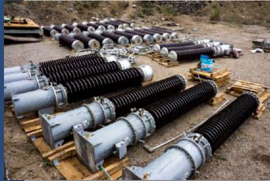
Transformadores de voltaje capacitivo (Arocloros A-1242, A-1254 A-1260)
