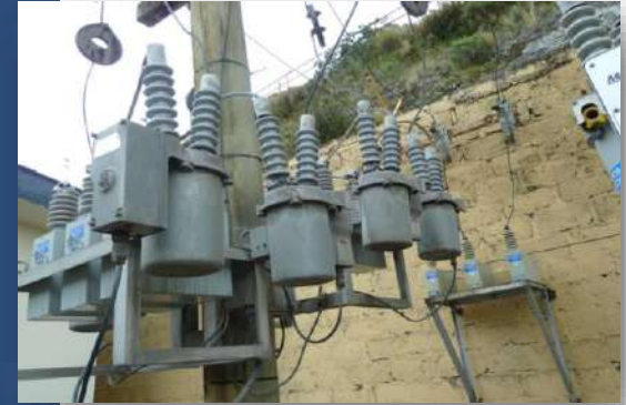
Capacitores (Arocloros A-1016, A-1221, A-1254)
