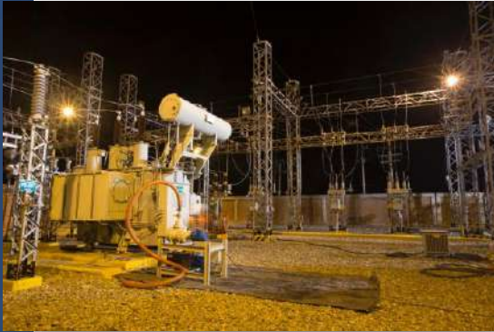
Transformadores (Arocloros A-1242, A-1254 A-1260)
